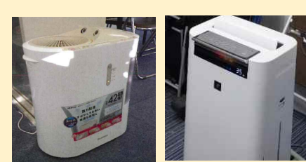
空気清浄機を設置
