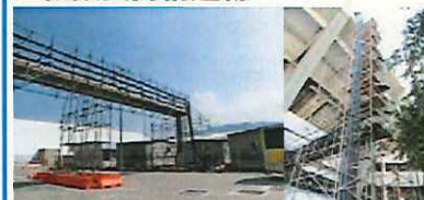
放送用コンパウンド～競技会場 ケーブル配線用構造物
