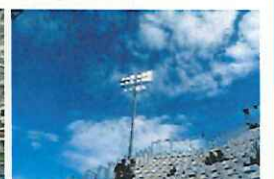
屋外競技 仮設照明・鉄塔
