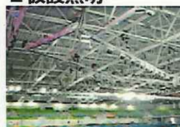
競技場の天井照明 屋外スタンド照明
