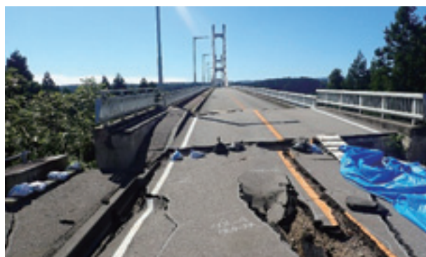
<道路部分の損傷>
