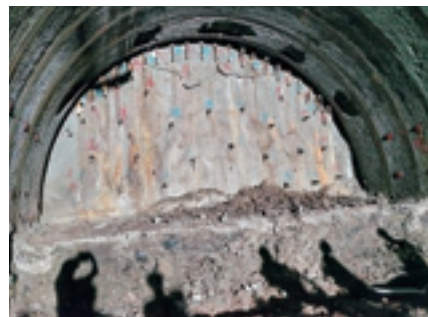
写真6 掘削終点鏡面（吹付上部に亀裂）
