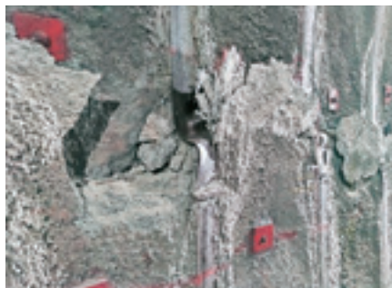
写真4 鋼製支保工の座屈状況
