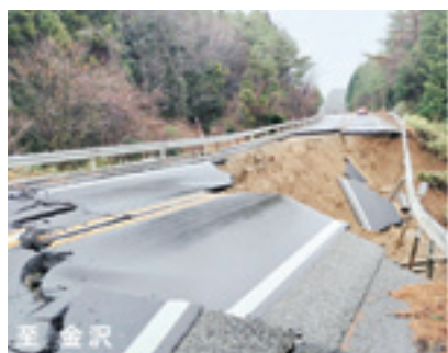
写真-2 被災直後（盛土の大規模崩壊）
