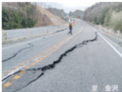
写真-5 被災直後（路面の亀裂・段差）
