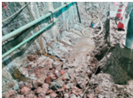
写真5 インバート部鋼製支保工の変形
