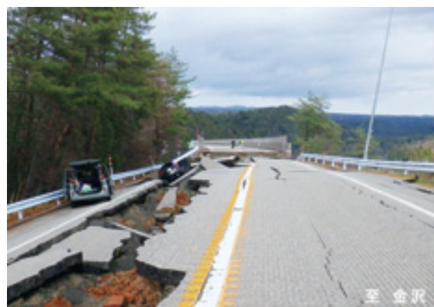
写真-8 被災直後（盛土の大規模崩壊）
