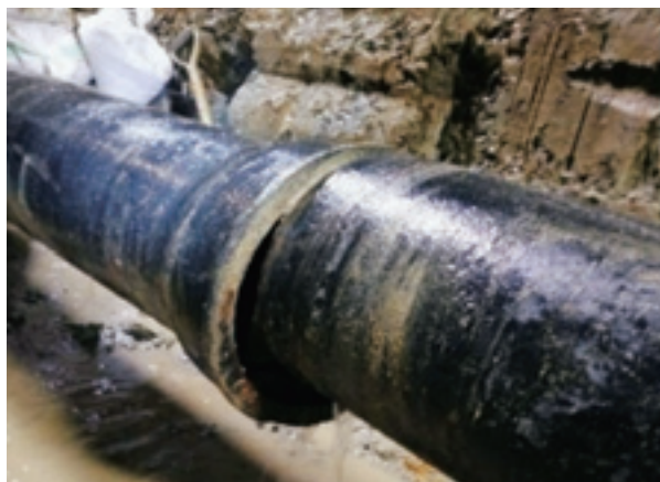
写真-5 非耐震管の被災状況（継手の抜け出し）
