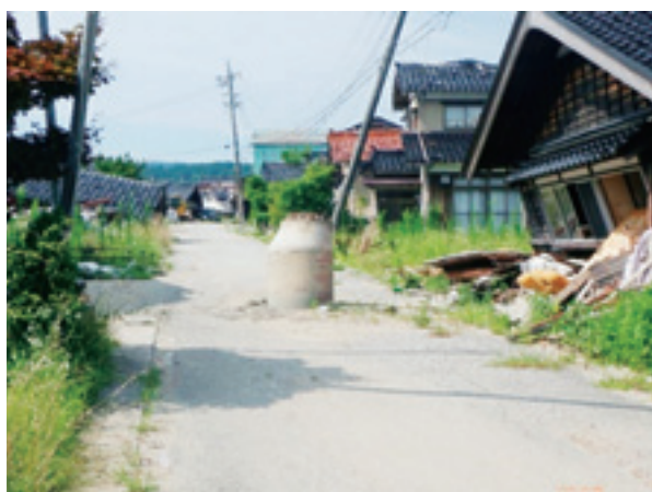
マンホールが液状化により隆起
